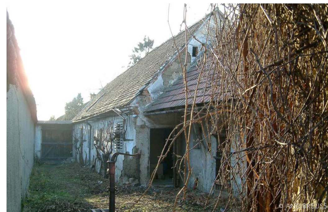
Lehmhaus erbaut 1850, Zustand nach 35 Jahren Leerstand (2004)
